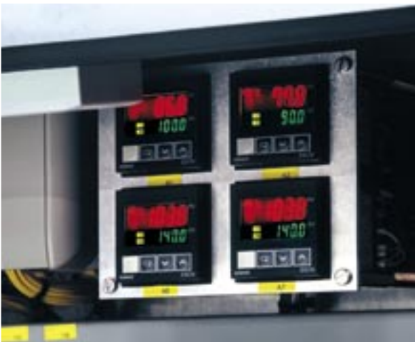
Omrons temperaturregulatorer E5CN används i Repaks maskinstyrningspaneler för att reglera värmningen.
